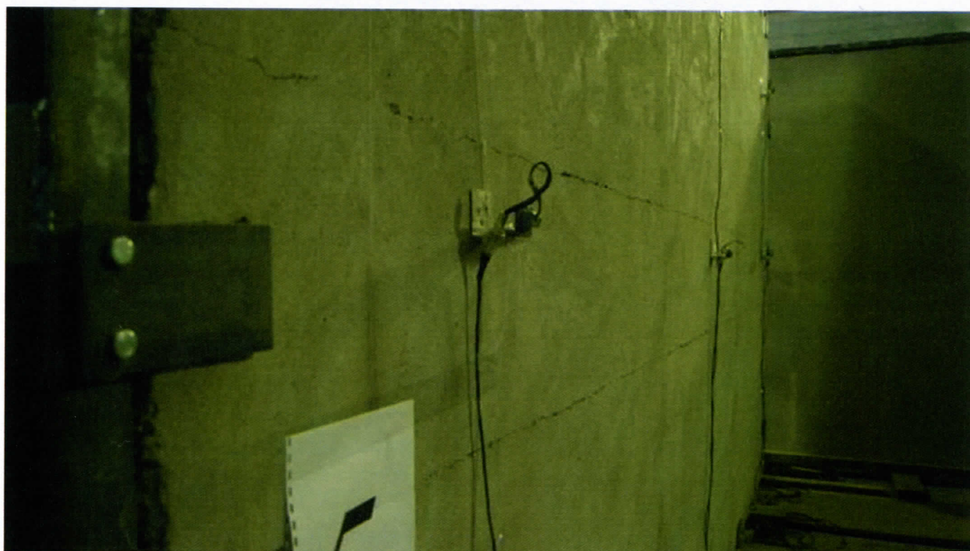
Рисунок 5.3.4 – Трещины по длине перегородки
