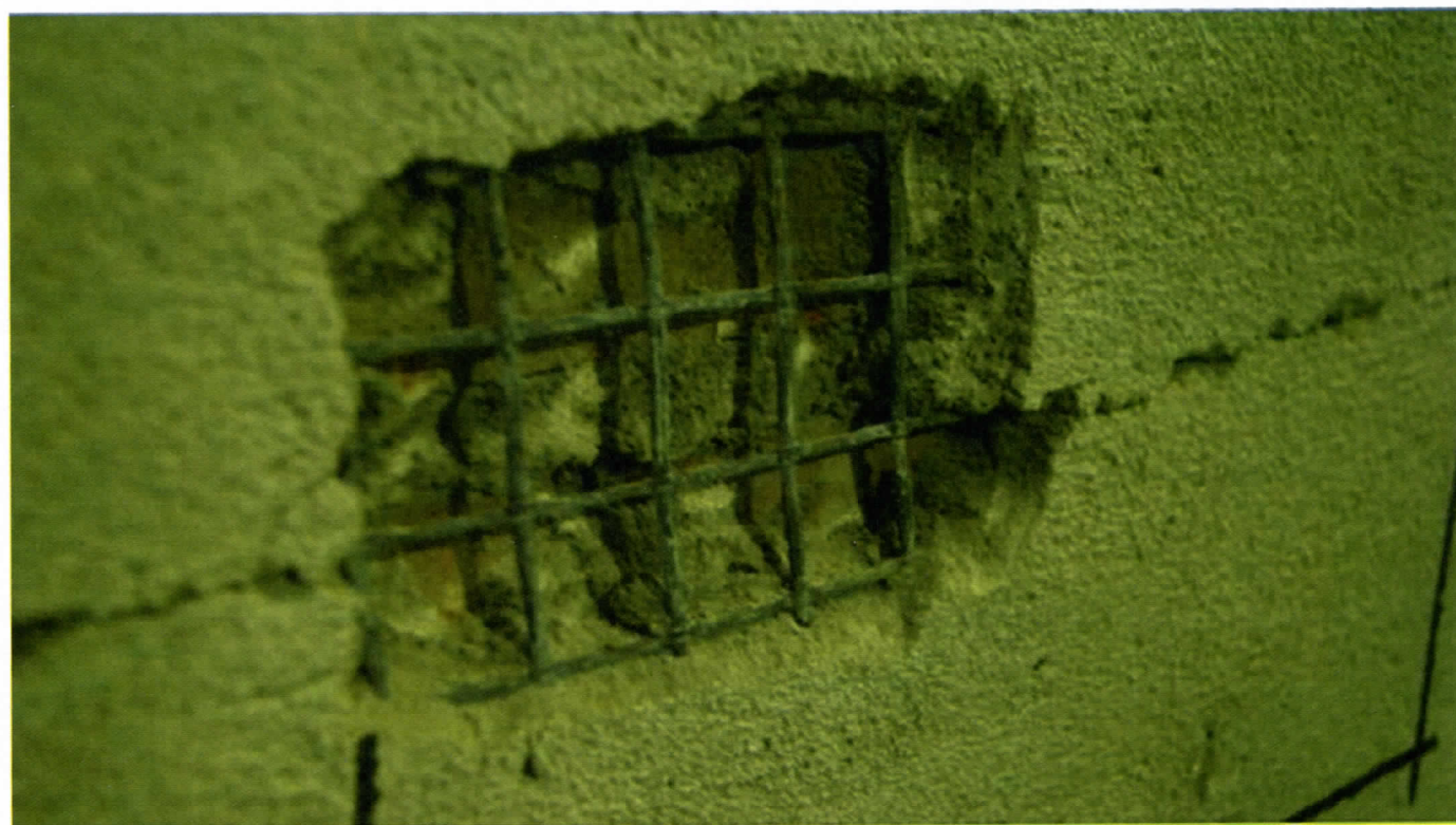
Рисунок 5.3.6 – Отсутствие повреждения базальтовой сетки (вертикального армирования) в месте прохождения трещины
