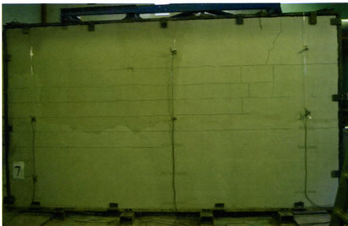
Рисунок 5.5.3 – Трещины по длине перегородки. Начало разрушения по схеме «конверт»
