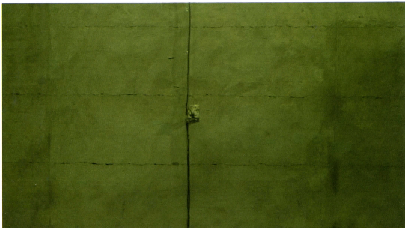
Рисунок 5.3.5 - Общий вид трещин
