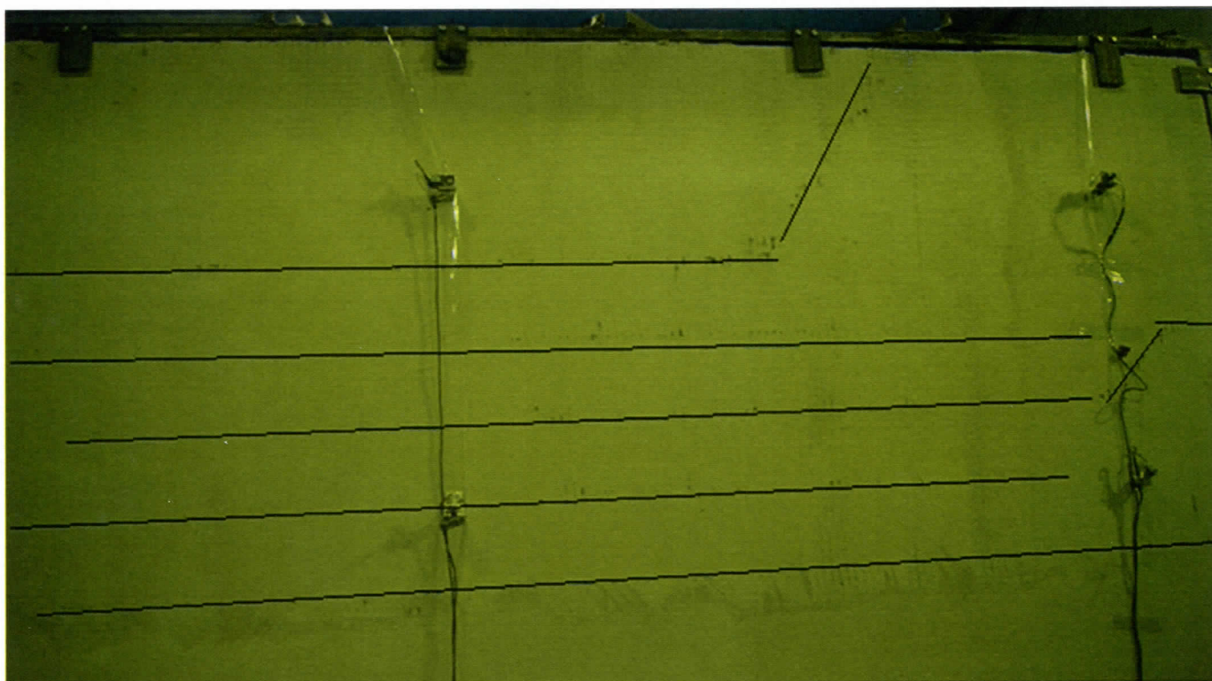
Рисунок 5.4.5 – Трещины по длине перегородки
