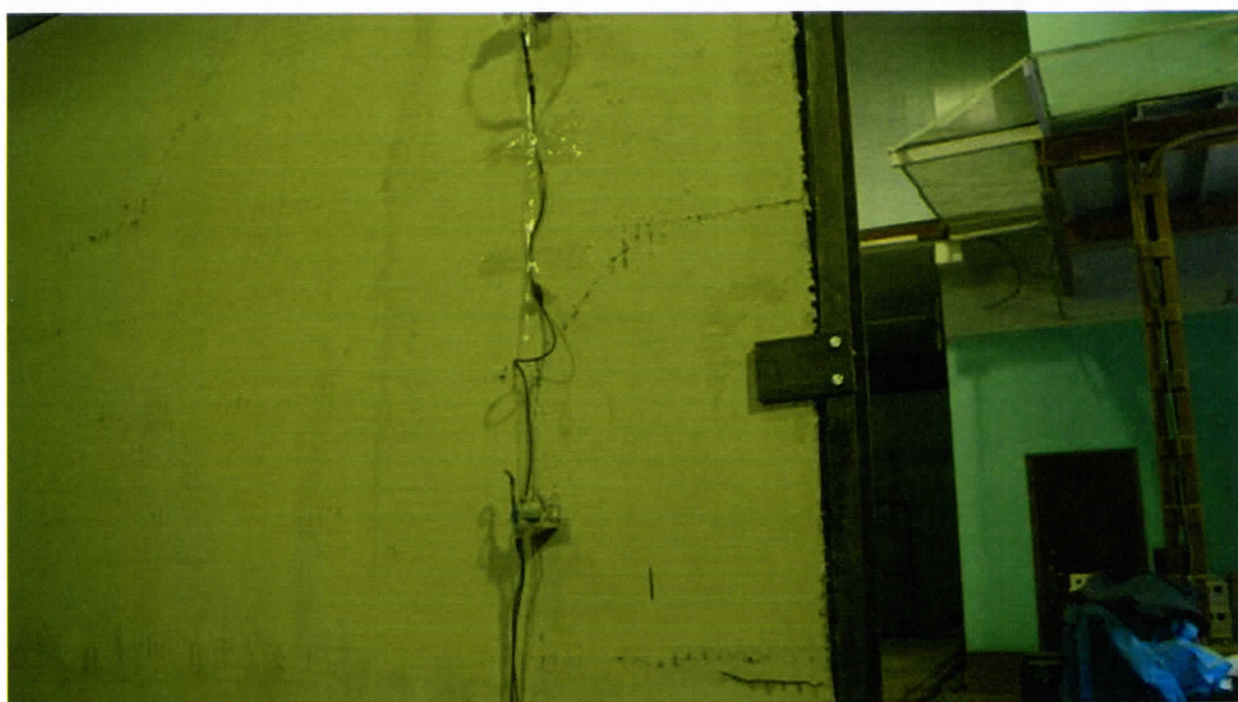
Рисунок 5.4.6 – Трещины в приопорных зонах
